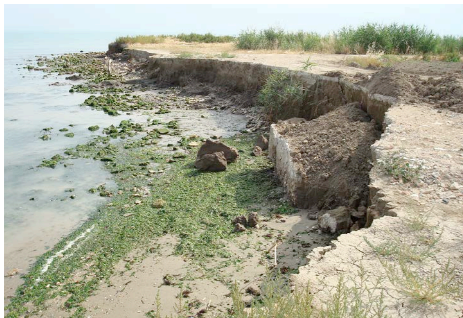
Casi di erosione presso la foce dell'Ofanto
